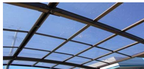
カーポート破損
