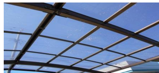
カーポート破損
